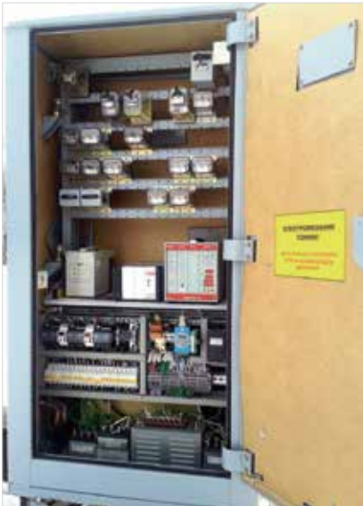
Релейный шкаф АРС-МП с НСУ
