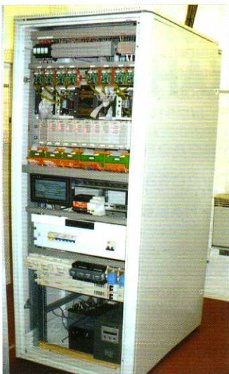
Станционный шкаф УВК ПРУ
